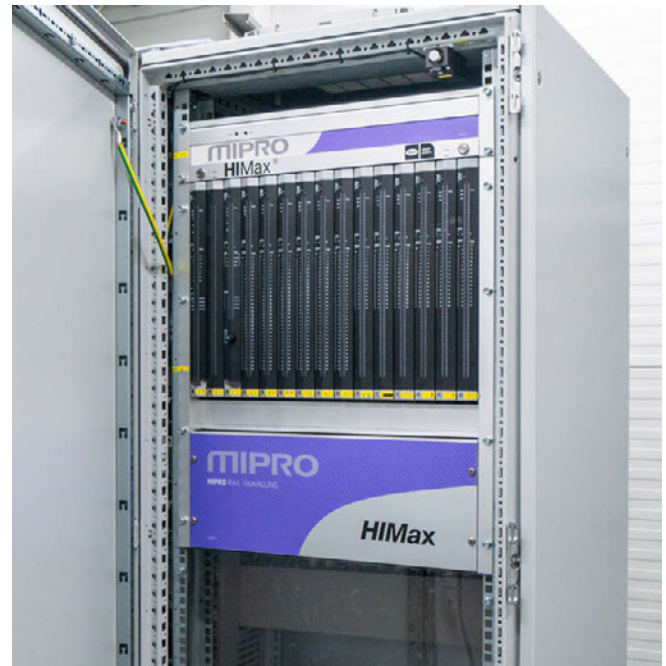
Bild 4: Stellwerkshardware im Einbauschränk Fig. 4: The interlocking hardware in the cabinet
